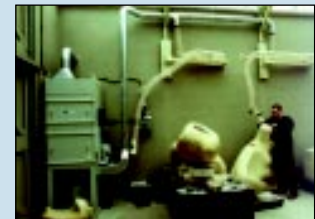
Установка с дополнительной взрывозащитой в мастерской скульптора.
